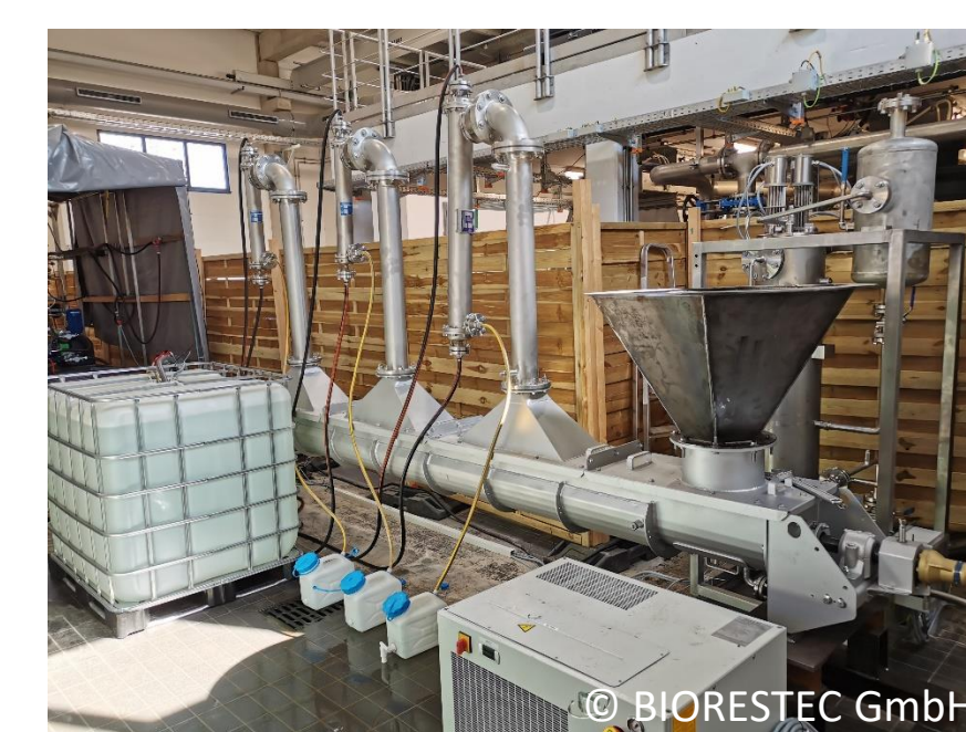
Abbildung 4: Versuchsanlage zur Trocknung von KS mit gleichzeitiger N-Rückgewinnung
