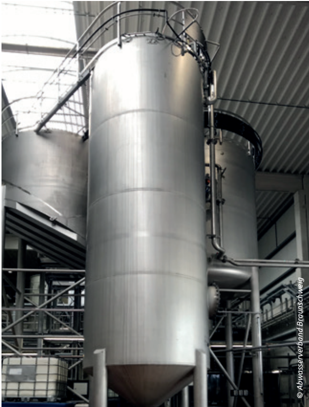
Abb. 2: Großtechnische Struvit-Anlage auf der Kläranlage Braunschweig.
